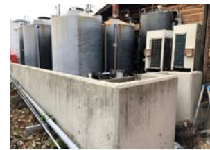
止水ブロック (高潮対策)
